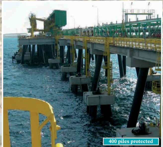
Above: LNG Jetty, Libya - SeaShield Series 2000 FD.
