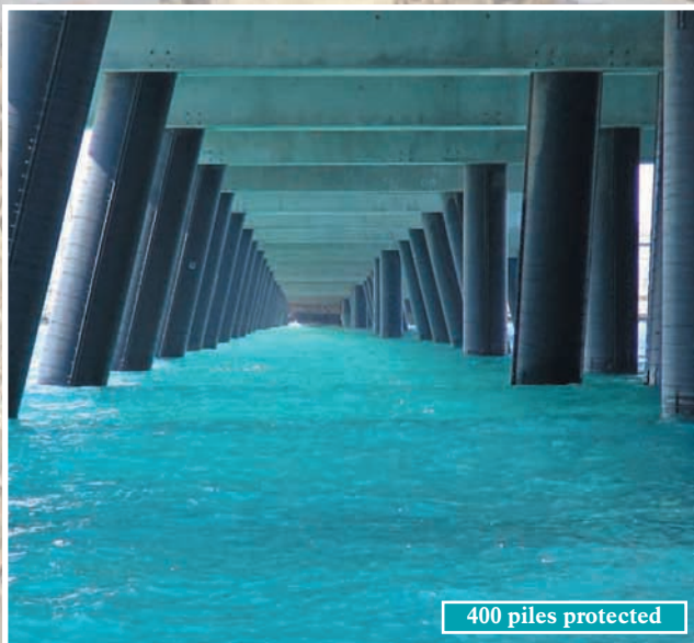
Above: LNG Jetty, Libya - SeaShield Series 2000 FD.
